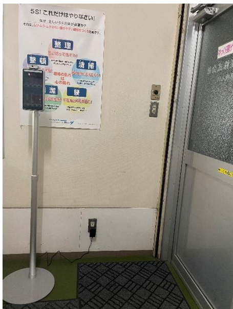
サーモカメラ付検温器の設置
